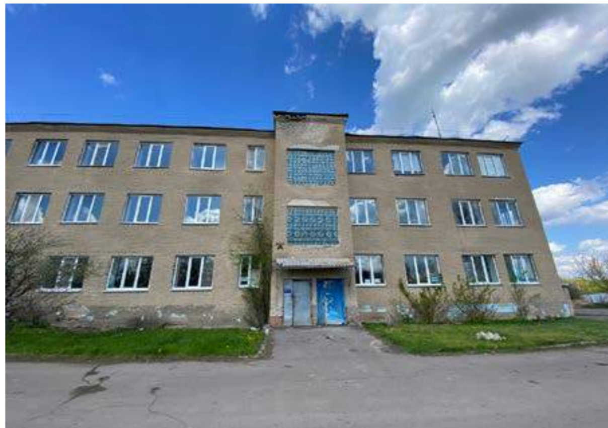
Больница (в аварийном состоянии, закрыта)
