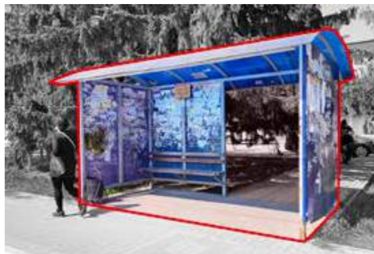
неудовлетворительное состояние остановочных павильонов
